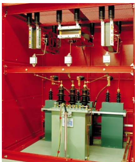
20kV Parallelankopplung zur Einspeisung von Rundsteuersignalen.
