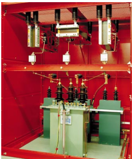
20kV Parallelankopplung zur Einspeisung von Rundsteuersignalen.
